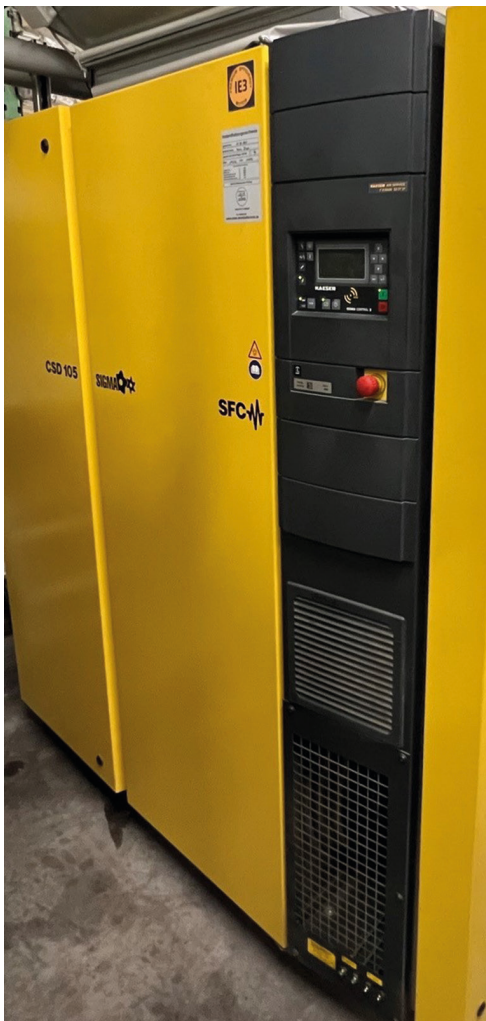
Abb. 2: Zentrale Druckluftversorgung der Druckerei.
